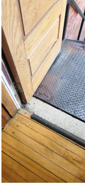
FIG. Div.8. 26 – West Balcony Door Threshold
