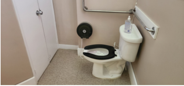
FIG. Div.15. 9 – Barrier-free Toilet
